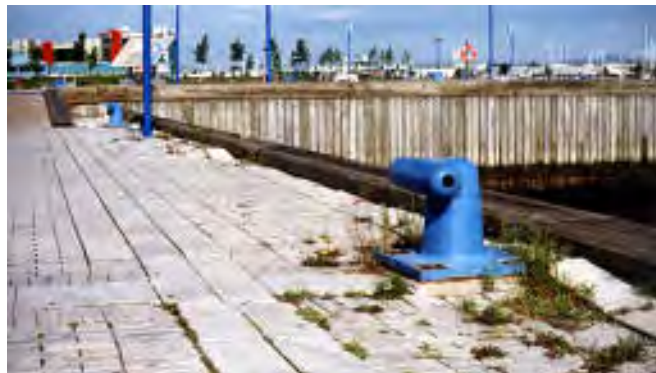
Photo 5 : État de dégradation de certains aménagements qui ont plus de 15 ans.
